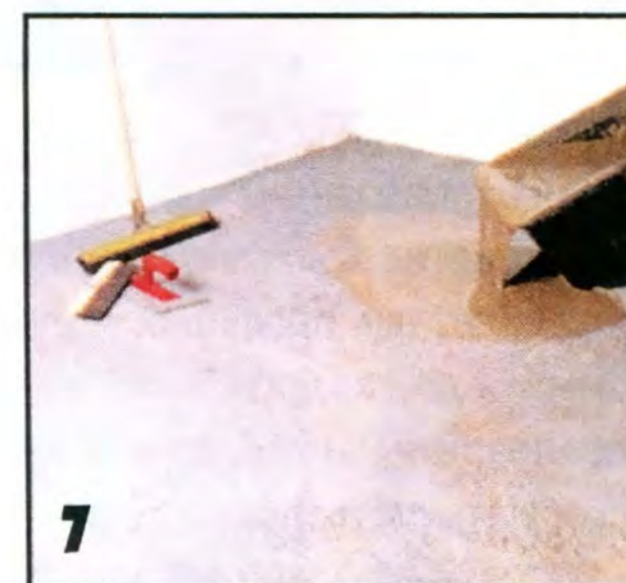
7 В сухую ремонтную смесь добавляют воду строго по рецептуре. Готовый раствор должен быть вязким. Выравнивающий раствор наносят на пол участками, начиная от дальнего угла.
