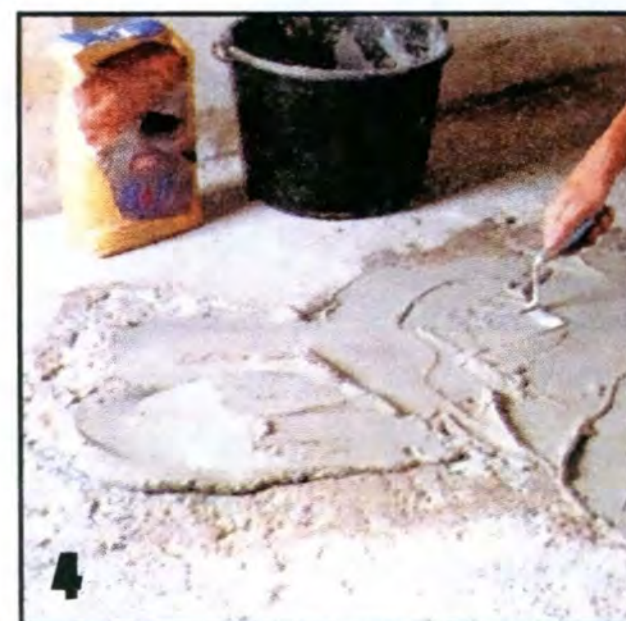
4 Глубокие выбоины заливают раствором, так как толщина слоя плиточного клея не должна превышать 10 мм.
