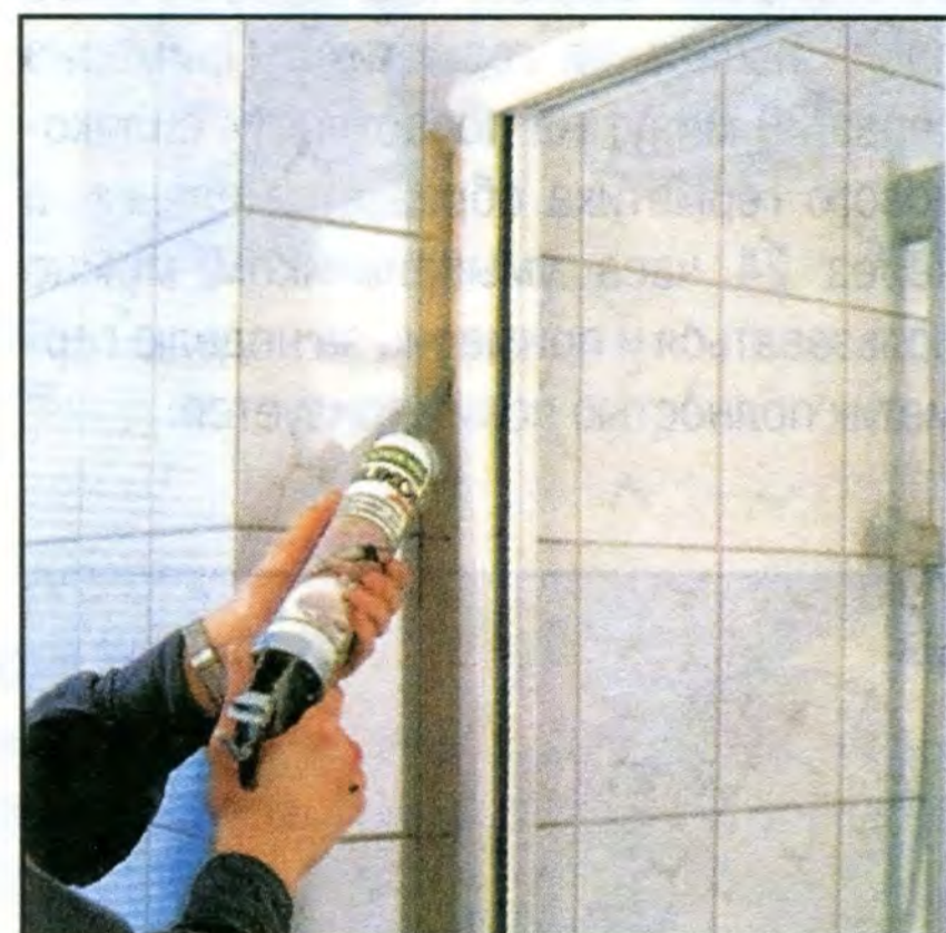
Изнутри душевую кабинку уплотняют герметиком для обеспечения водонепроницаемости, а снаружи — для красоты. Здесь уже не появятся грибок и плесень.
