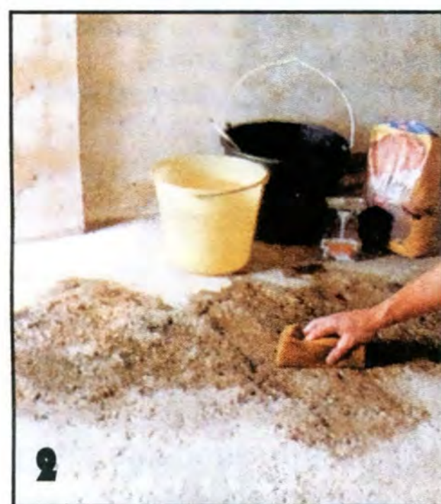
2 Глубокие выемки в полу заливают ремонтным раствором, очистив предварительно участок от пыли влажной губкой.
